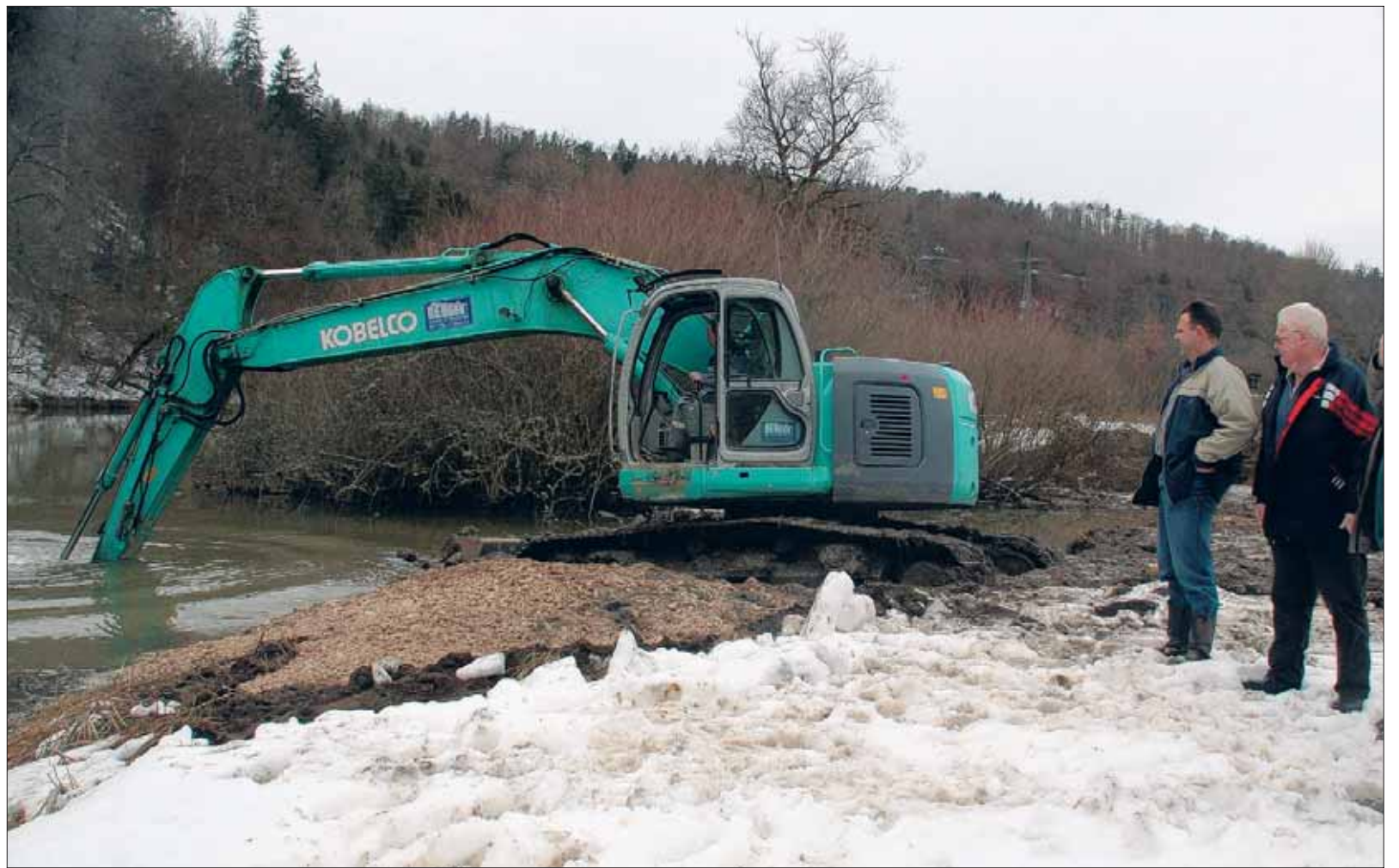
Mit schwerem Gerät geht es bei der Renaturierungsmaßnahme an der Donau an die Arbeit.
